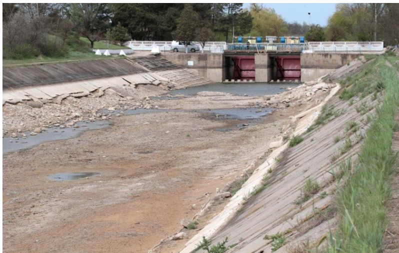
Рисунок 2 – Техническое состояние Северо-Крымского канала до заполнения водой
